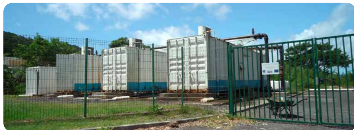
Usine de dessalement de Pamandzi
